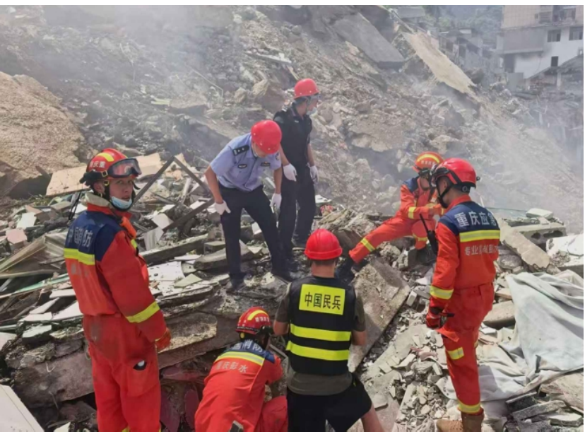
7月17日9时10分许,重庆市彭水县汉葭街道乌江三桥附近发生山体崩塌灾害事故,重庆市公安局统一指挥,彭水县公安局第一时间响应,全警迅速投入参与抢险救援,群众转移安置、秩序维护工作,图为彭水县公安局民警正在参与救援。
