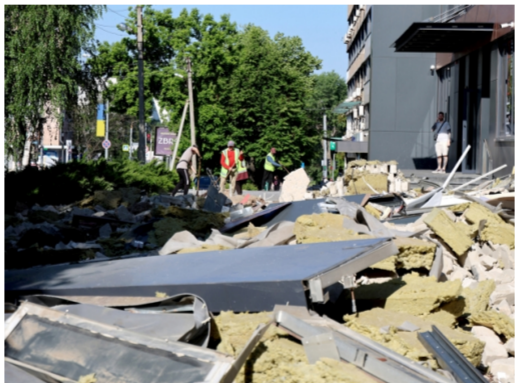
图为当地时间2026年6月9日，乌克兰哈尔科夫，市政工作人员在一栋被俄军无人机袭击损毁的建筑外清理瓦砾。俄军对该市发动了大规模无人机袭击，对居民楼和民用基础设施的袭击造成15人受伤，其中包括3名儿童。 CFP供图
