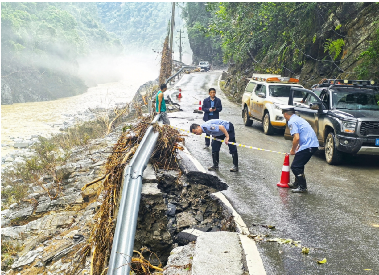
连日来,湖南省石门县受强降雨影响多地暴发山洪,石门公安交管大队组织警力深入辖区开展险情排查与交通疏导工作,并对危险路段进行管控。图为5月23日,民警在受损路段放置警示标志。
