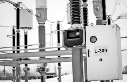
当地时间2025年2月8日，拉脱维亚雷泽克内，变电站110千伏电流的电源开关，标志着拉脱维亚与俄罗斯之间主要电力线路的断开。波罗的海三国于2月8日断开与俄罗斯及白俄罗斯的共同电网系统，加入欧洲电网。(CFP供图)
