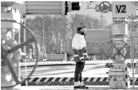
目前欧洲面临最冷冬季,天然气供应担忧加剧。图为欧洲天然气储存设施内的天然气管道和阀门。 CFP供图
