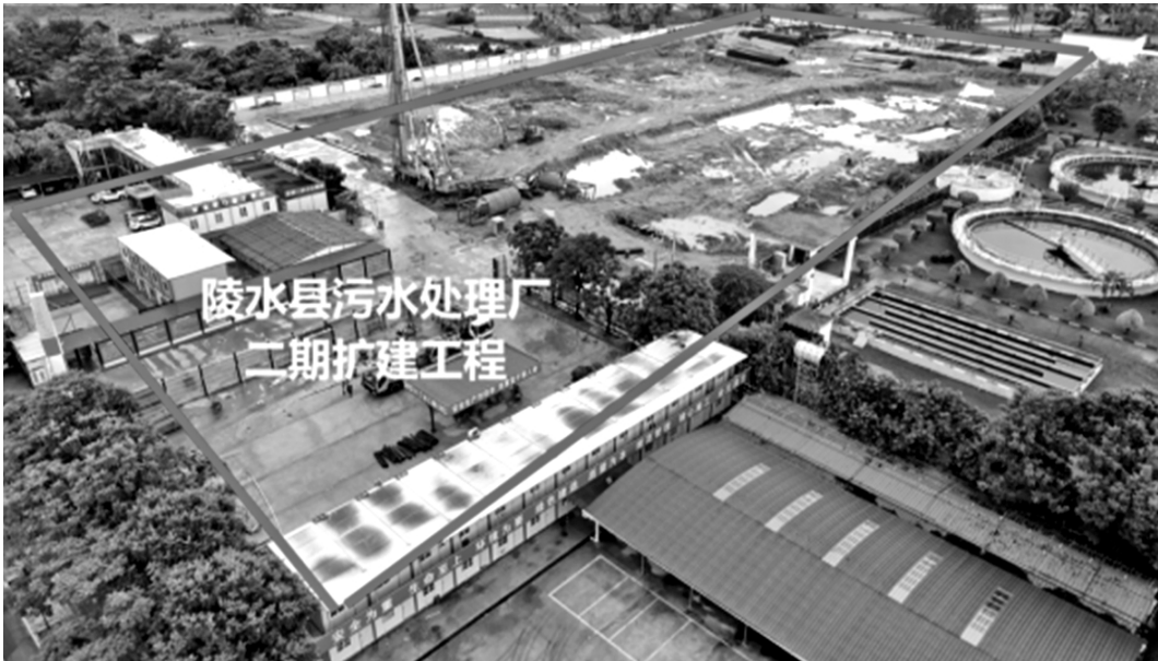
图为12月2日,中央生态环境保护督察组现场督察发现,陵水县污水处理厂二期扩建工程仍在施工,未按期完成。(中央生态环境保护督察组供图)
