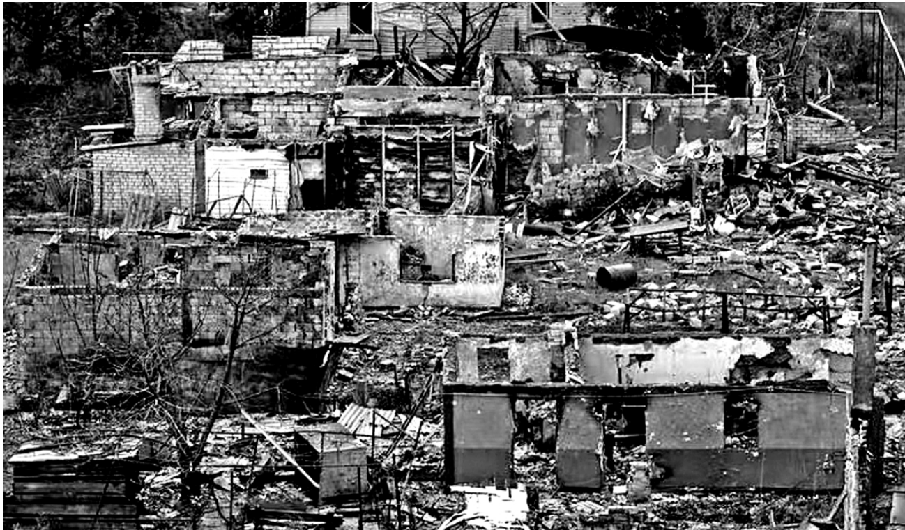
图为5月26日在卢甘斯克波帕斯纳亚拍摄的被损坏的建筑。
