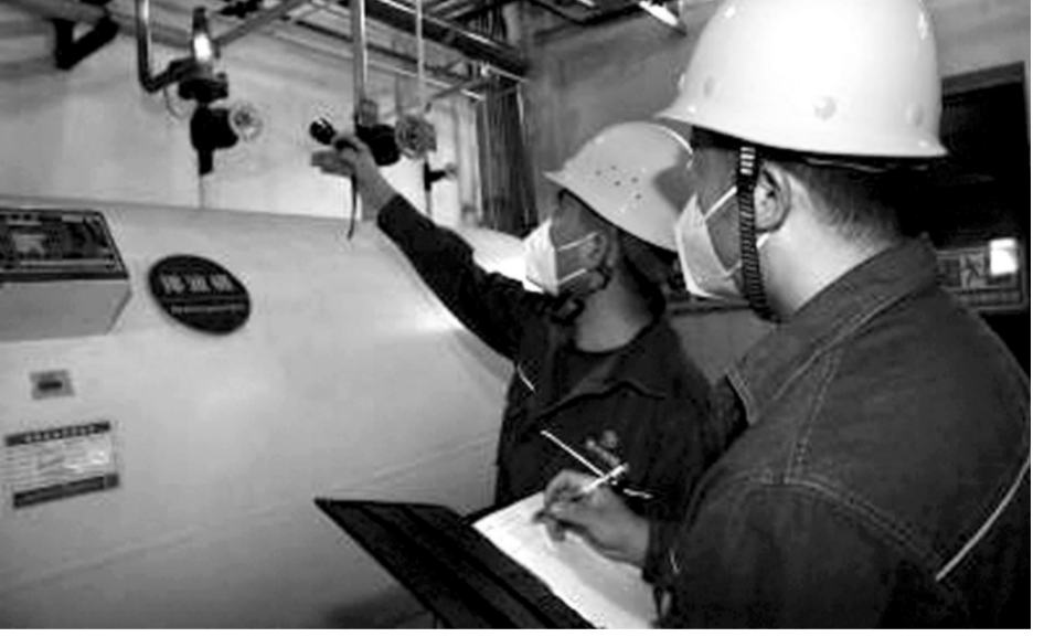
连日来，北京市通州区市场监督管理局工作人员深入辖区各大企业，为受疫情影响未能按时检验的特种设备进行检验，尽快让辖区企业恢复生产经营。图为该局特种设备检测所工作人员来到蒙牛乳业（北京）有限责任公司，对24台压力容器进行定期检验，并对企业园区内改造的压力管道进行监督检查，确保设备安全稳定运行。
