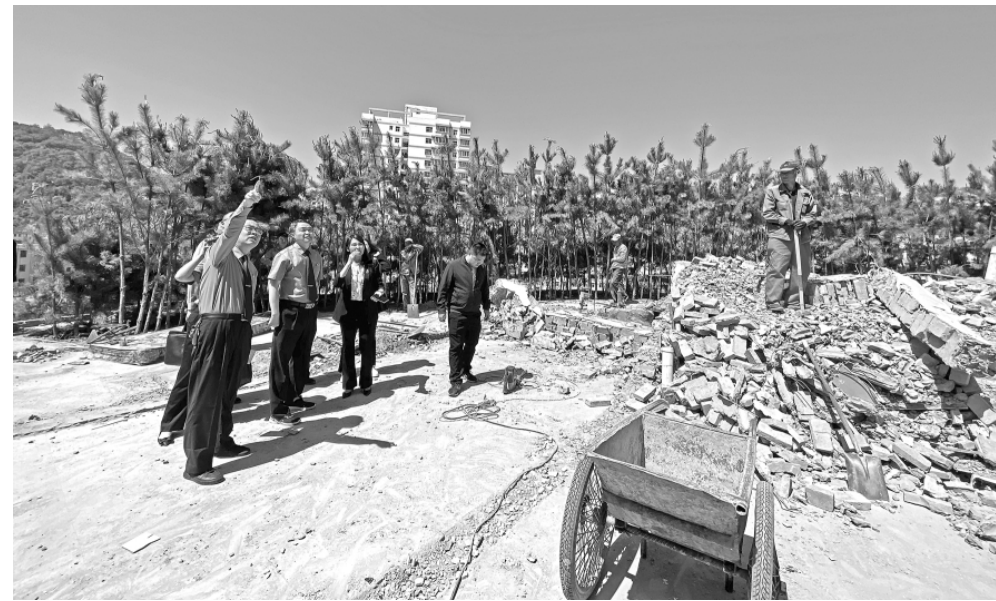
图为陕西省、市、县三级检察机关查看延安市志丹县检察院办理的保安革命旧址违建拆除案整改现场。
