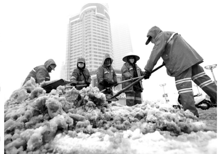
2月7日起，安徽省合肥市普降大雪，合肥市瑶海区组织城管、园林、交警等部门及各街镇开发区成立铲雪除冰应急抢险队，对辖区内立交、人行天桥以及240条主次干道进行划片分区开展铲雪，保障了交通畅通及车辆、行人安全出行，展现了良好应急处置能力。图为工作人员在铲除积雪。
