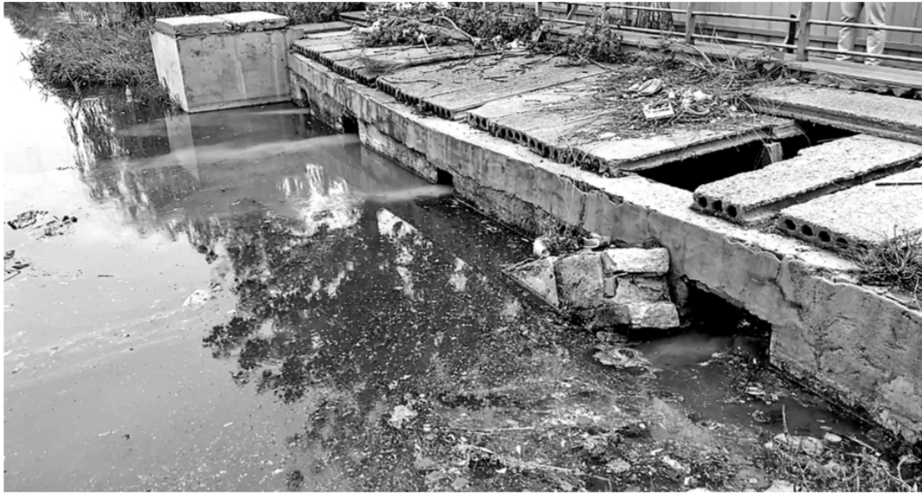
2021年6月督察组暗查发现,菏泽市老城区大量生活污水经溢流口直排青南河。
