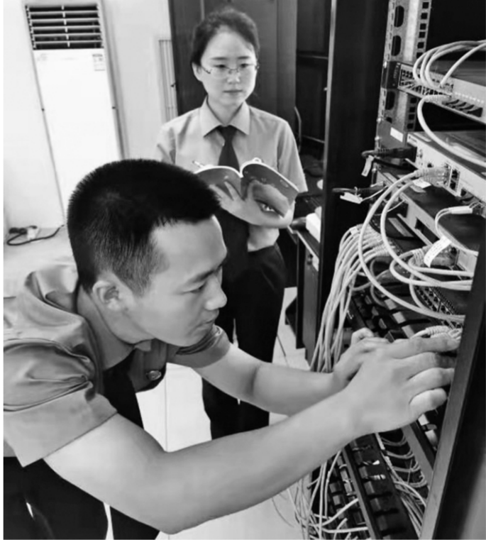
黑龙江省铁力市检察院技术部门干警定期利用下班时间,对机房网络设备进行检修维护,确保检察工作不受网络设备故障影响,突出了科技强检的作用。 本报通讯员 那伟宁 摄
