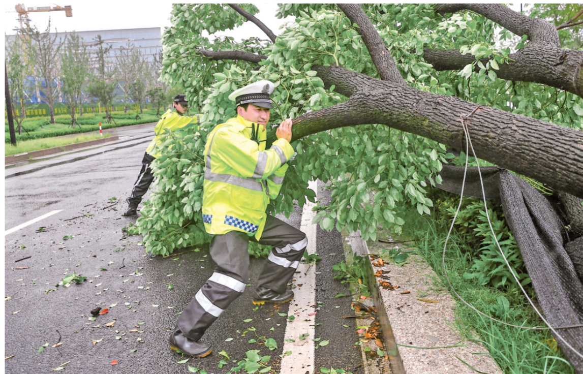
图为七月二十六日上午，临平公安交警大队民警清理被风吹倒的树木，及时消除安全隐患。
