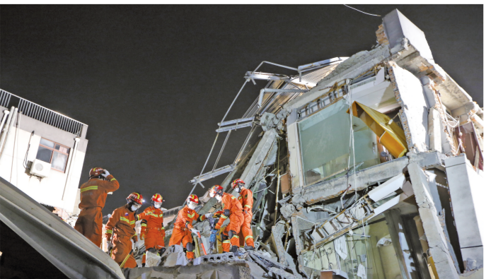
▲7月12日,江苏省苏州市吴江区松陵街道油车路188号四季开源酒店辅房发生坍塌事故,消防救援人员赶赴现场施救。CFP供图
