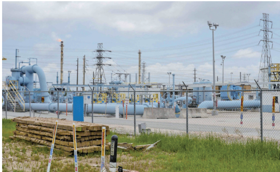
图为当地时间2021年5月10日,美国最大燃油运输管道运营商科洛尼尔管道运输公司的设施。 CFP供图
